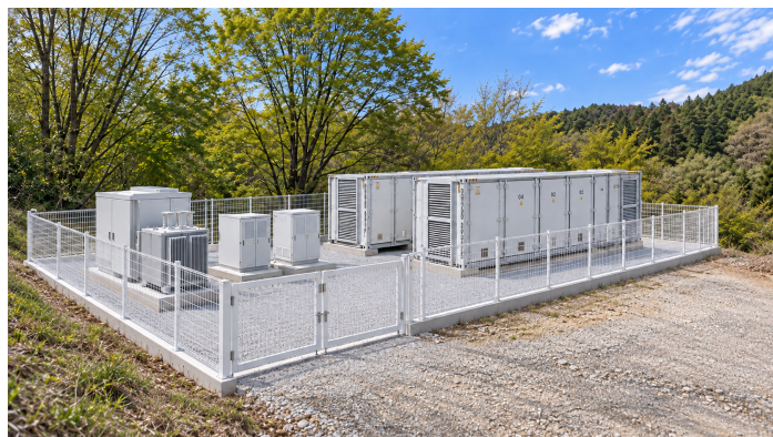
系統用蓄電所完成イメージ
